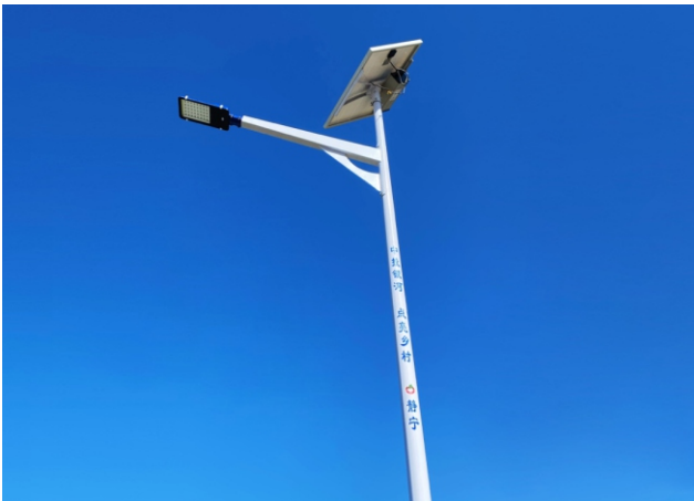
“中投银河点亮乡村工程”项目在静宁县建设的太阳能路灯
